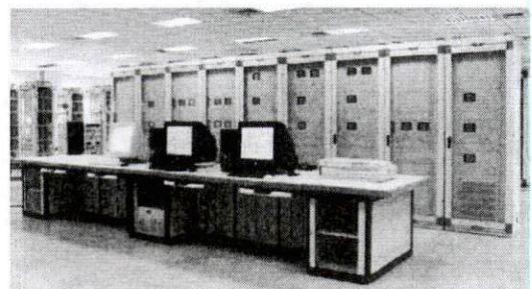
Hệ thống tự động hóa trạm biến áp
