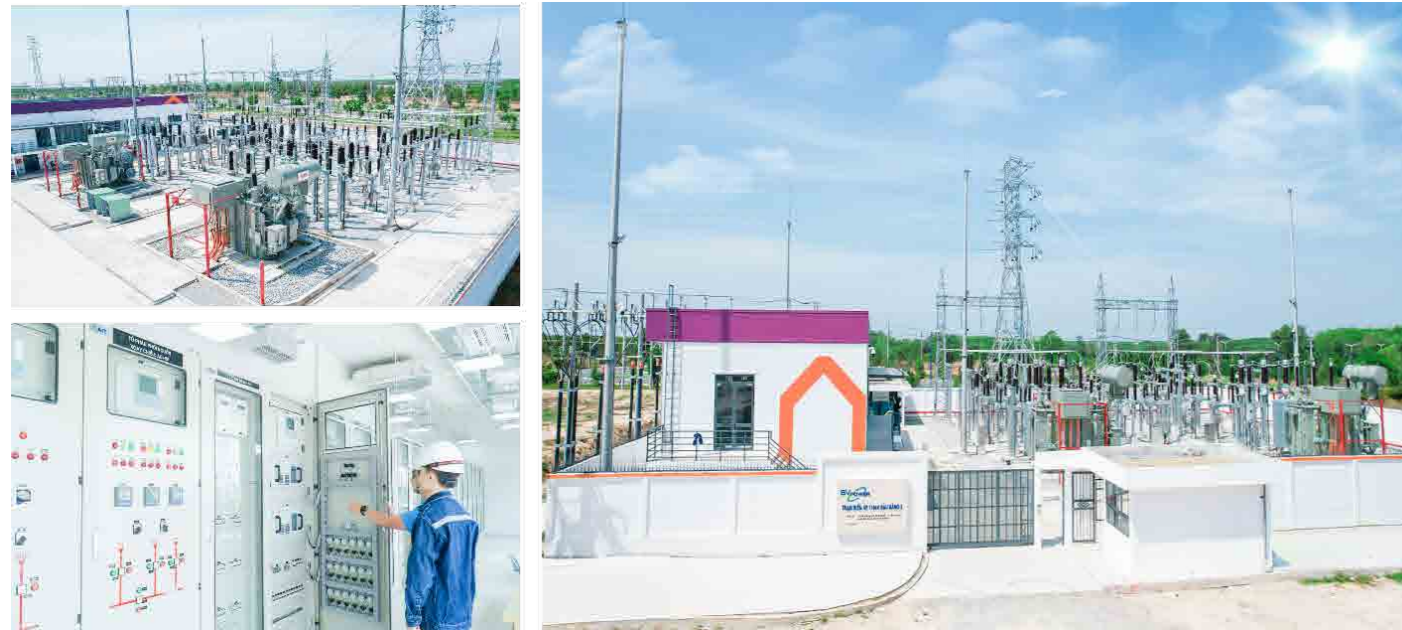
Trạm Biến áp 110/22kV Bàu Bàng 2 (2x63 MVA) – Ngày Vận hành Thương mại: 12/2024
