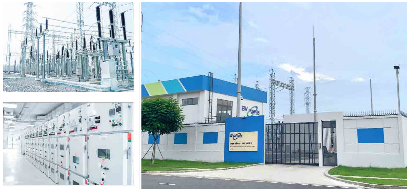
Trạm Biến áp 110/22kV VSIP 3 (2x63 MVA) – Ngày Vận hành Thương mại: 06/2025
