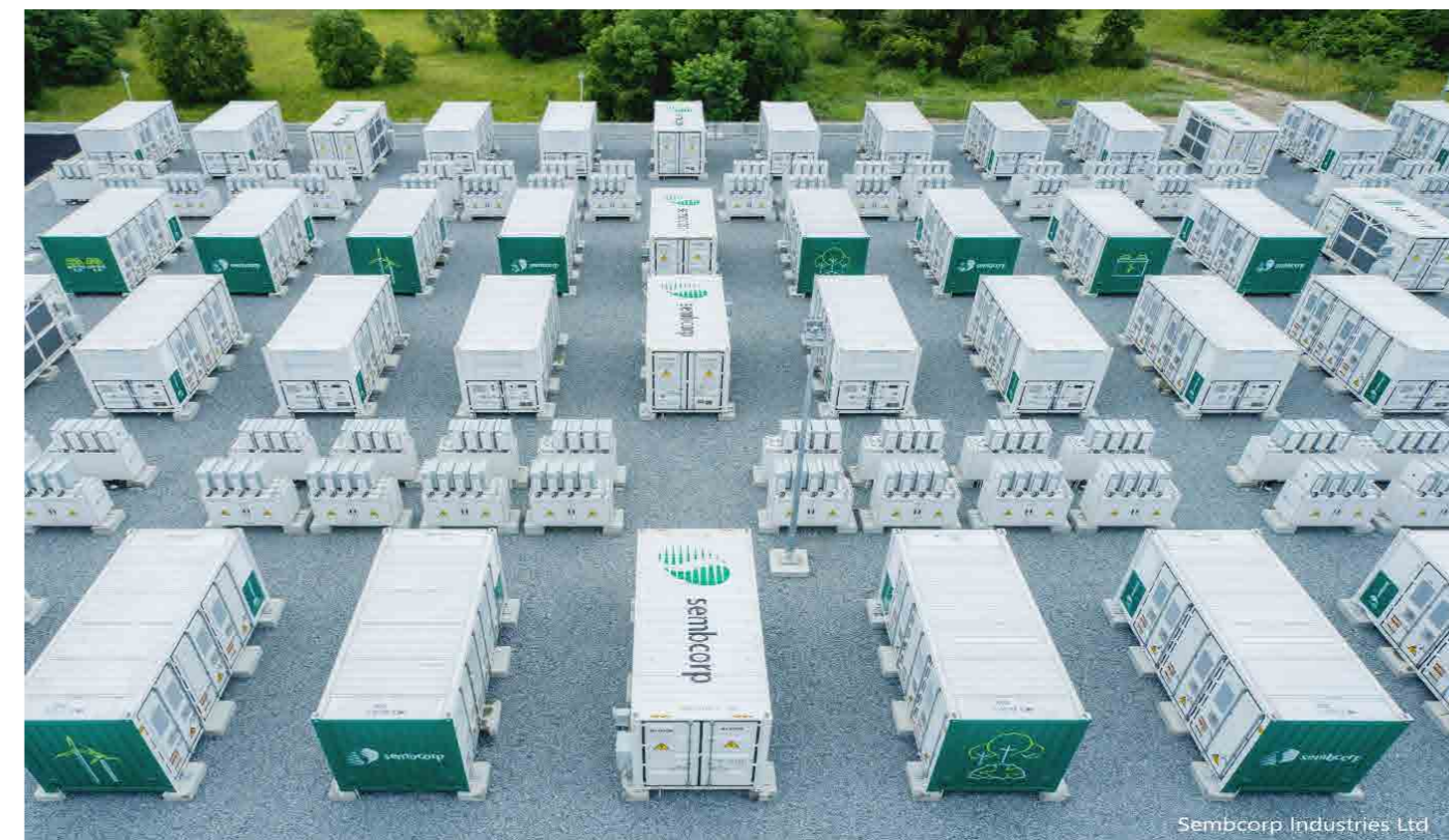
Dự án BESS 284 MWh – Đảo Jurong (Singapore)
