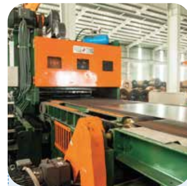
HỆ THỐNG COIL CENTER
