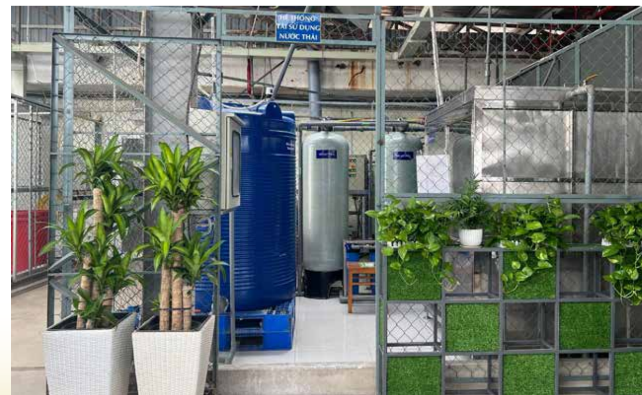
Hệ thống xử lý nước thải tại nhà máy PNJ
