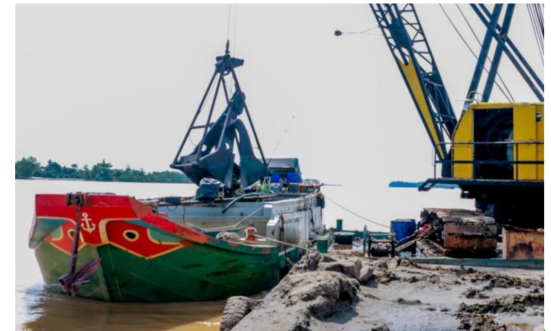
Khai thác cát sông phục vụ thi công Dự án thành phần 4 cao tốc Châu Đốc - Cần Thơ - Sóc Trăng
