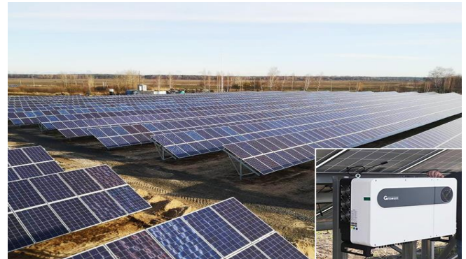
Nhà máy điện mặt trời PV
