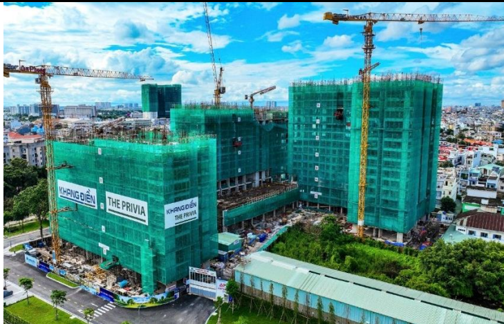
Hình 10: Dự án The Privia – Gồm 3 block đang thực hiện xây dựng: Block A đang xây dựng tầng 16, Block B đang xây dựng tầng 18, Block C đang xây dựng tầng 21.
